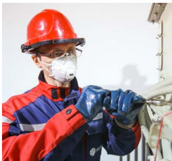
5 Электрослесарь Александр Верба проводит плановое обслуживание
