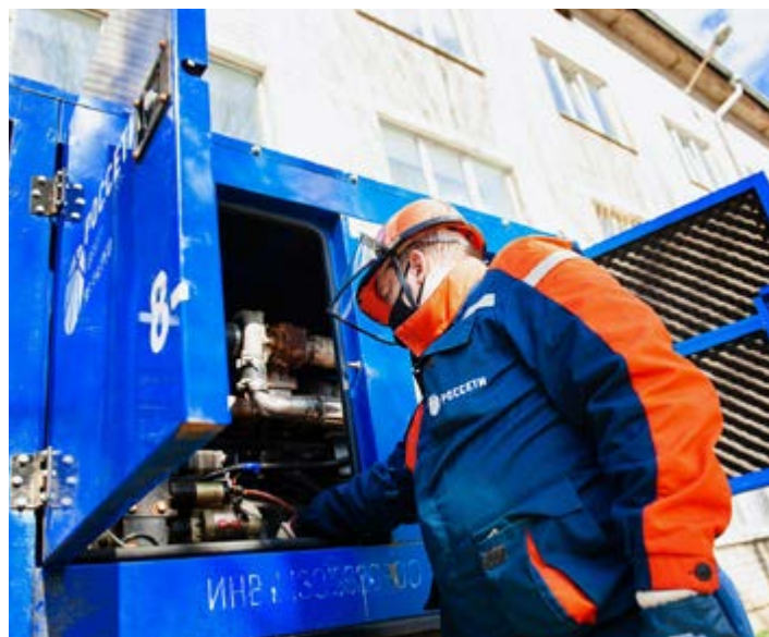
Специалисты филиала «Ярэнерго» обеспечивают дополнительной мощностью больницу имени Н. А. Семашко
